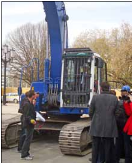
Wowi mit dem Bagger: Den ersten Rammschlag für den U-Bahnhof Berliner Rathaus führte der Regierende Bürgermeister Klaus Wowereit höchstpersönlich aus.
