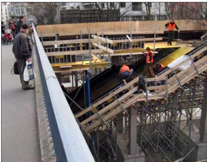
S-Bahnstation Kolonnenstraße im Bau. Man hätte es kaum geglaubt: Die seit 1987 versprochene Station nimmt Form an. Sie soll am 30. April 2008 eröffnet werden. Foto: Kay Röllig, 9. Februar 2008
