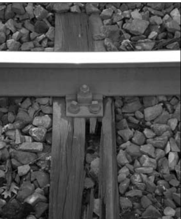
Schwellenschaden am Hauptgleis von Berlin nach Dresden im Bereich des brandenburgischen Bahnhof Blankenfelde.
