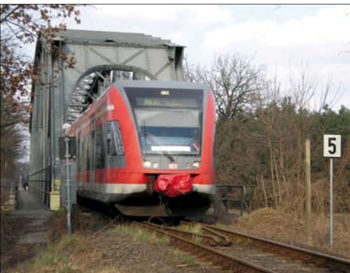
Ein typisches Beispiel für die vielen Mängel bei der Eisenbahninfrastruktur: Auf der Brücke über die Spree im Verlauf der Strecke Fürstenwalde—Bad Saarow muss die Geschwindigkeit auf 50 km/h reduziert werden.
